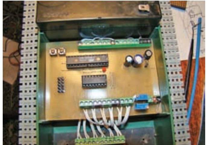
Вид на плату сверху
